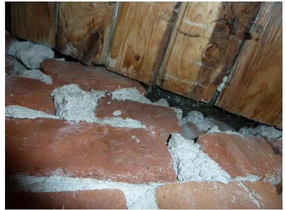
Kuva 11. Kattolaudoituksen takana oleva bitumi-huopa-aluskate sisältää asbestia.
