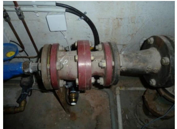
Kuva 5. Tila 036, laippatiivisteet sisältävät asbestia.
