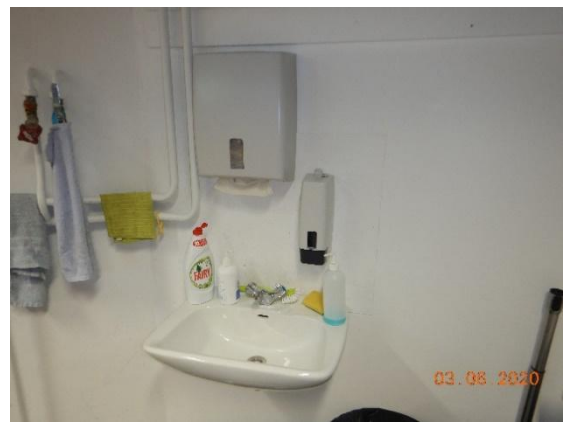
Kuva 7. Tilan 001 altaan ohut taustalevy sisältää asbestia.
