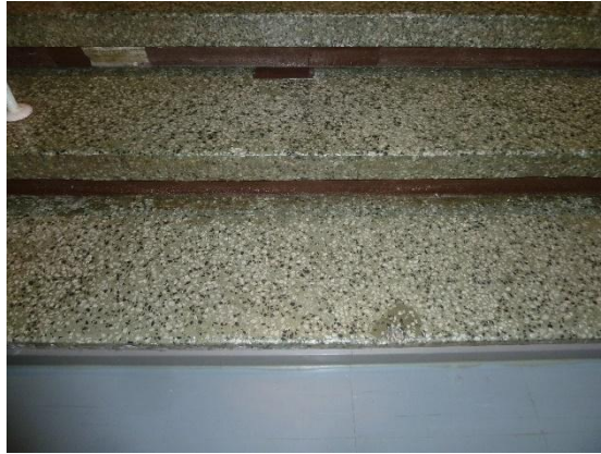
Portaan ylösnostossa oleva massa/ kivilista ei sisällä asbestia.
